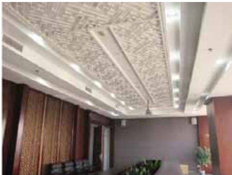
政府会議室 LED照明導 入事例
