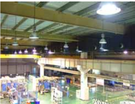
無錫THK工場 LED照明導入 事例
